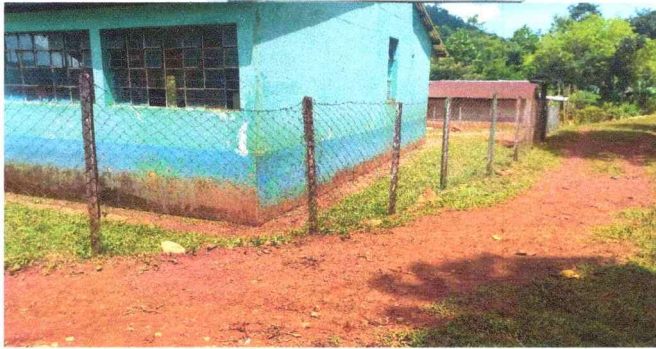
Foto 3: SUSTITUCION DE MALLA INSERVIBLE Y POSTES PODRIDOS POR MALLAS NUEVAS Y TUBOS GALVANIZADOS
